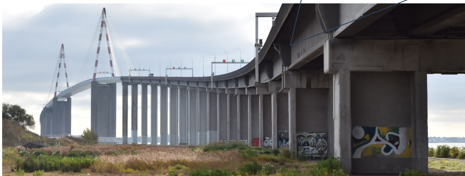
Il Ponte di Saint-Nazaire, costruito negli anni '70, è ancora oggi il ponte più lungo di Francia. Per la maggior parte delle sue armature non fu prevista una protezione contro la corrosione, il che ha reso necessario nel tempo un vasto programma di manutenzione e riparazione. Circa 63 tonnellate di armature zincate sono state utilizzate in punti ben precisi: le estremità delle flange delle travi a T e le solette di collegamento gettate in opera posizionate all'altezza delle flange (foto in alto). Non è stata necessaria alcuna riparazione nei punti in cui sono state utilizzate armature zincate a caldo.
