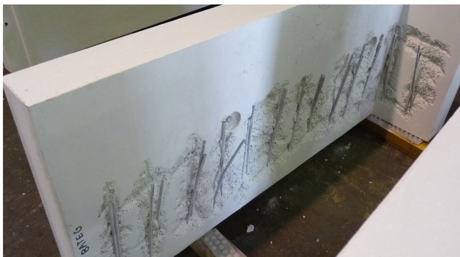
Armatures galvanisées exposées pendant la construction
